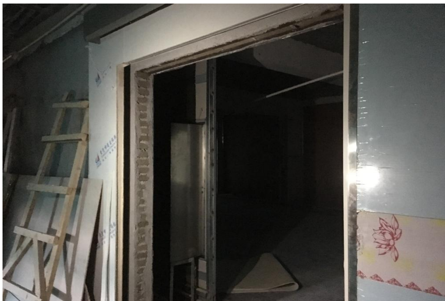
DSA 机房病人进出防护门照片
