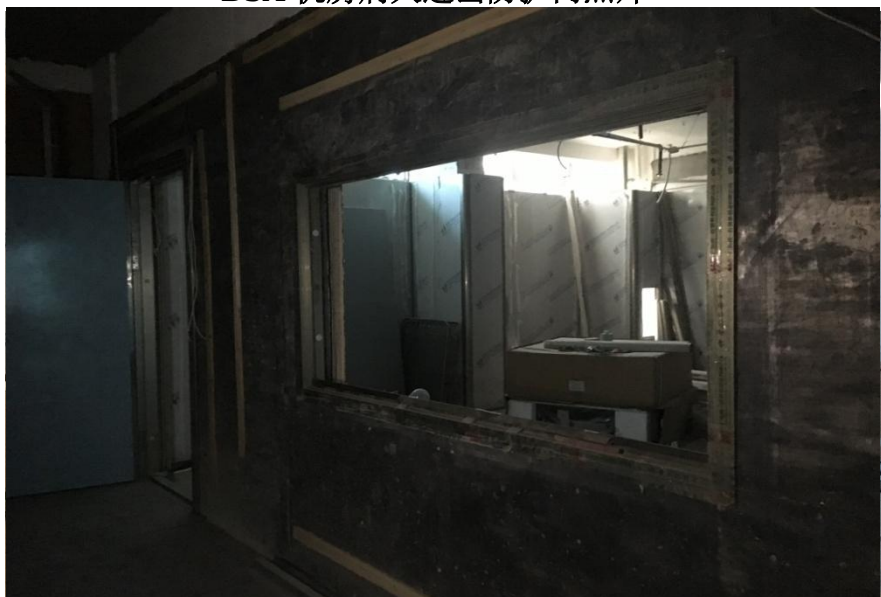
DSA 机房内照片
