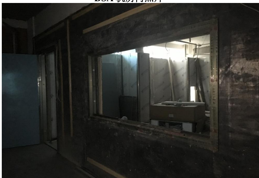
DSA 机房控制室现场照片
